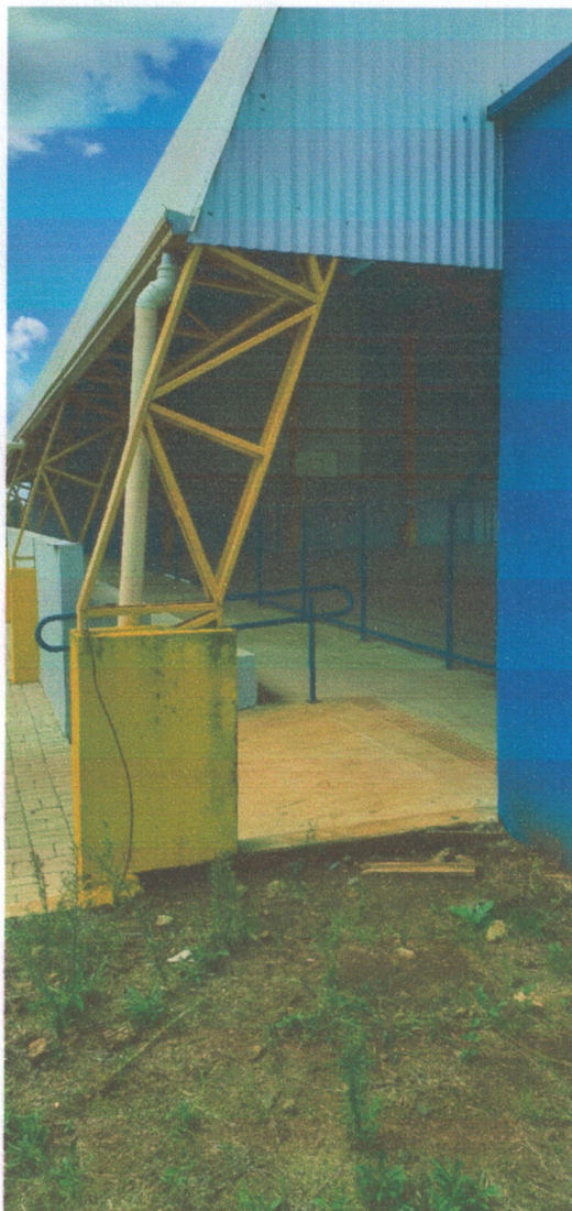
Figura 4 – Abertura na fachada dos fundos
