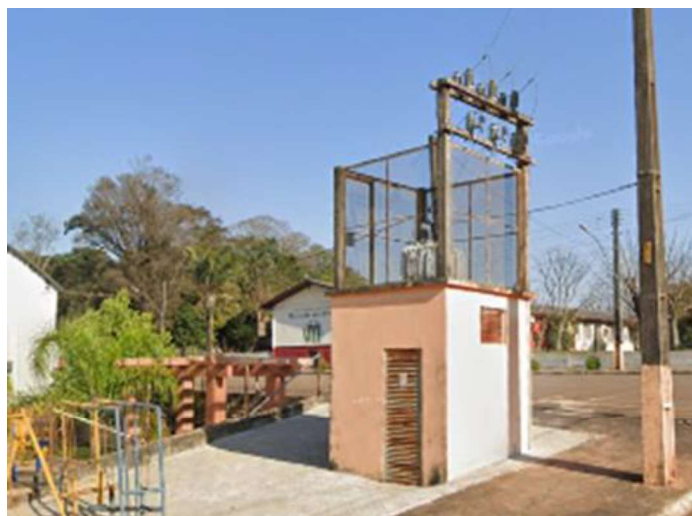
Figura 18 – Entrada geral de energia.
