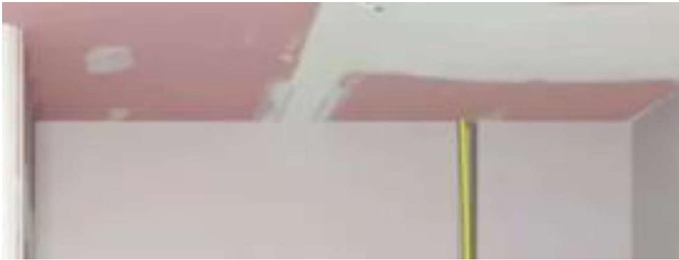
Figura 10 - Forro em Drywall resistente ao fogo (RF).
