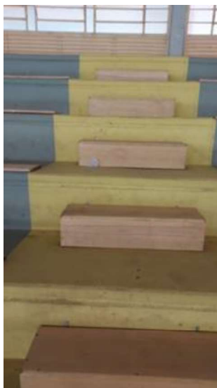
Figura 15 – Degraus intermediários, sem corrimão central e largura insuficiente.
