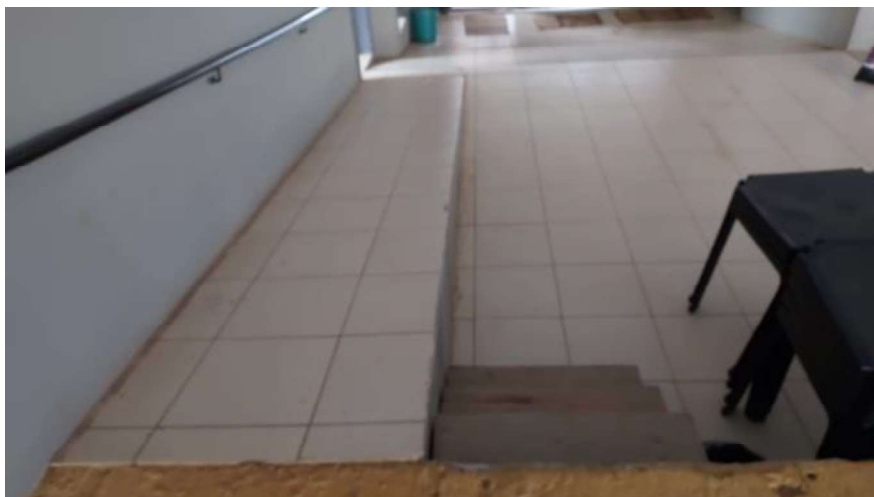
Figura 13 - Sem corrimão e guarda-corpos (barreira).
